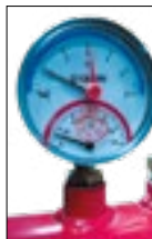
Термоманометр на выходе котла
