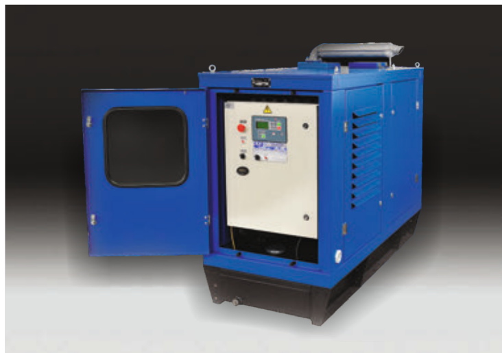
ДЭС в погодозащитном кожухе
